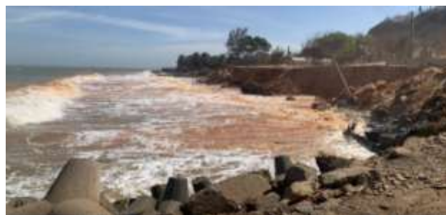
Tỉnh Bình Thuận đang từng bước xử lý tình trạng sạt lở bờ biển. Ảnh: KS.
