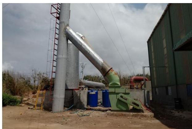
Hệ thống, thiết bị của nhà máy xử lý và tái chế Đa Lộc Phú Quý.
