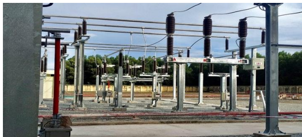
Ngăn lộ 110kV-E15 tại Trạm biến áp (TBA) 220kV Hàm Tân
