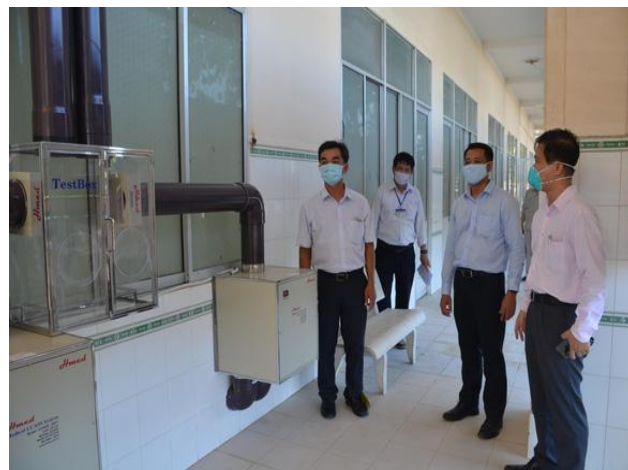
Hệ thống phòng cách ly áp lực âm tại Bệnh viện Đa khoa tỉnh Bình Thuận
