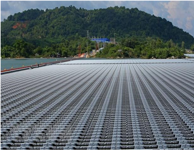
Hệ thống pin nhà máy điện Mặt Trời trên hồ thủy điện Đa Mi. (Ảnh: Ngọc Hà/TTXVN)
