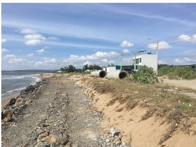
Tổng kho xăng dầu Dương Đông – Hòa Phú nạn vỡ và đã khắc phục được đoạn bờ sạt lở
