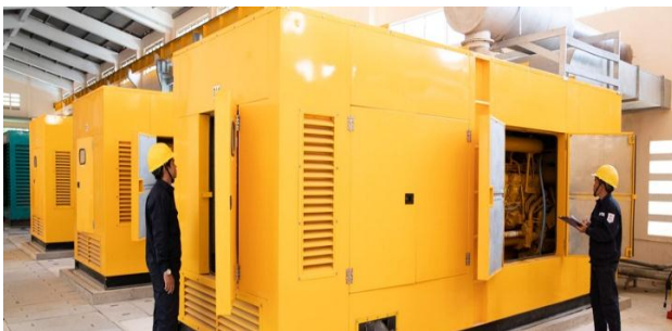
Bên trong nhà máy điện diesel do Điện lực Phú Quý quản lý. Đây là nguồn điện chủ lực cấp cho huyện đảo - Ảnh: Ngọc Tuấn.
