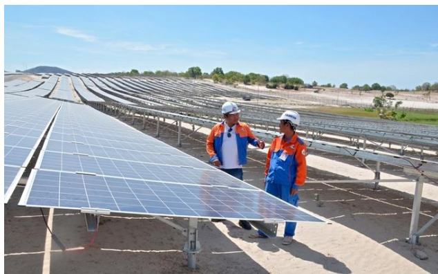
Một góc Nhà máy điện mặt trời Phong Phú.
