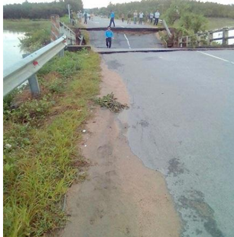
Cầu Trà Tân 2 bị sập-ảnh KH
