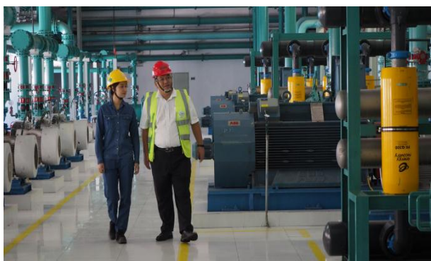
Hệ thống lọc nước biển tại nhà máy Nhiệt điện Vĩnh Tân 1.
