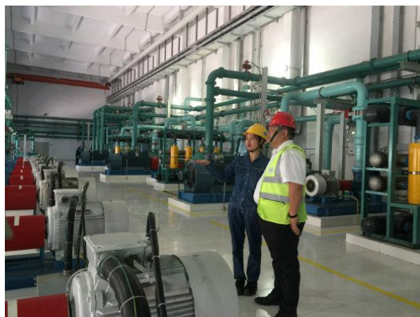
Hệ thống lọc nước biển của nhà máy
