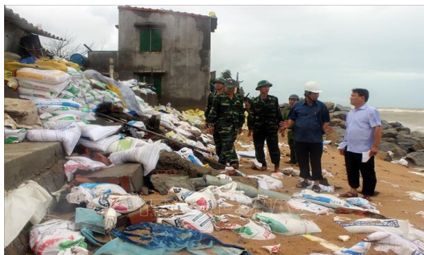
Bờ kè tại tỉnh Bình Thuận bị sóng đánh gây sạt lở.
