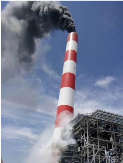
Sự cố hoả hoạn tại Nhà máy Nhiệt điện Vĩnh Tân 4 trong quá trình thi công, không gây thiệt hại về người.
