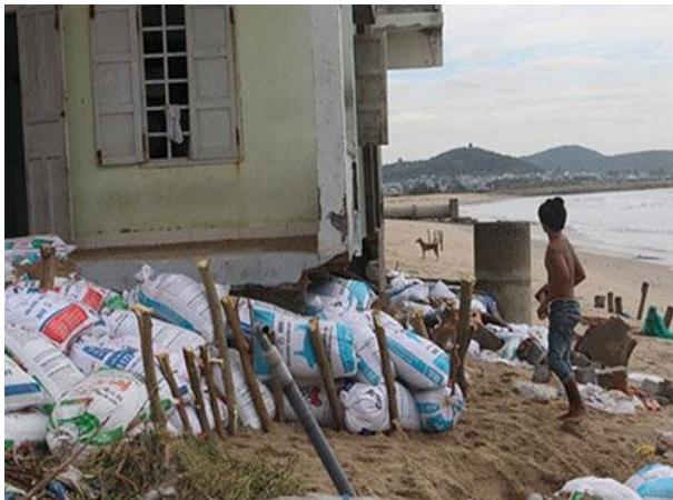
Sạt lở bờ biển tại Tp. Phan Thiết
