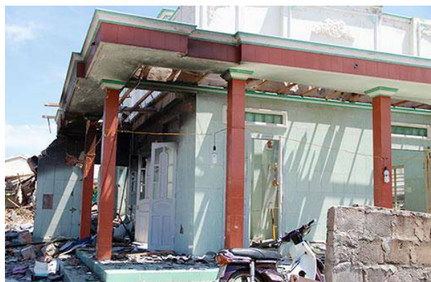
Một ngôi nhà bị ảnh hưởng của vụ nổ. Ảnh: Báo Bình Thuận
