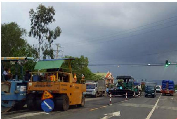
Một đoạn đường tuyến Đồng Nai - Phan Thiết không có dải phân cách và mới thi công đã phải sửa chữa.
