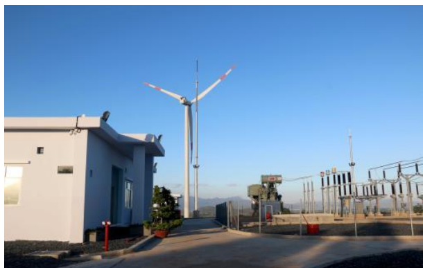
Trạm biến áp 22/110 KV Nhà máy điện gió Phú Lạc tại Bình Thuận. Ảnh: Nguyễn Thanh.
