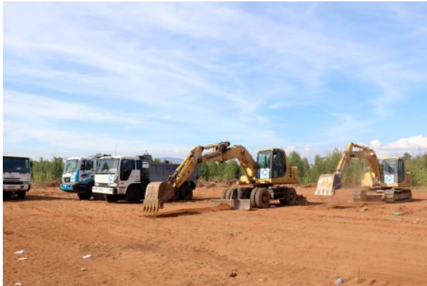
Dự kiến nhà máy sẽ đi vào hoạt động từ tháng 6/2017. Ảnh: Nguyễn Thanh - TTXVN
