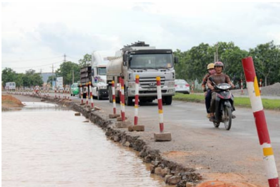
Thi công QL1 cả hai bên khiến lòng đường bị thu hẹp gây mất ATGT
