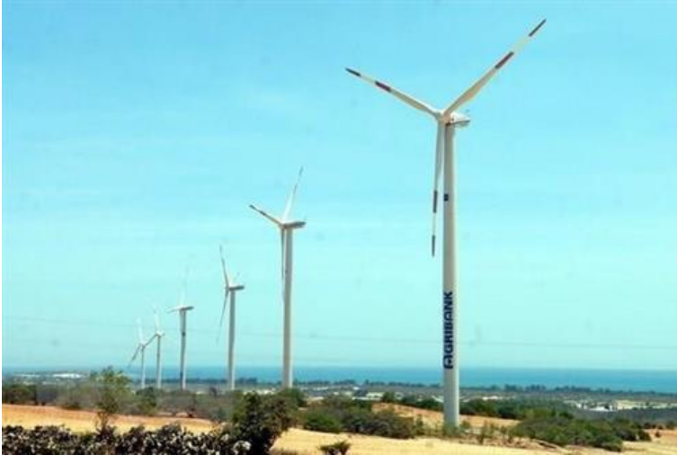
Hệ thống điện gió tại huyện Tuy Phong, Bình Thuận. Ảnh: Mạnh Linh - TTXVN
