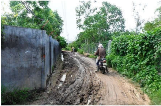
Hàng ngày, máng nước của nhà máy đổ trực tiếp khiến con đường bị hư hỏng
