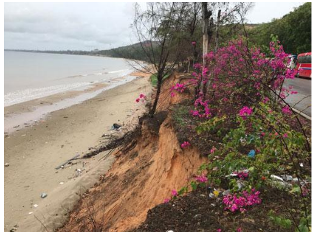
Khu vực bị sạt lở sát ngay taluy tuyến đường ĐT 706 (chỉ cách khoảng 2m)
