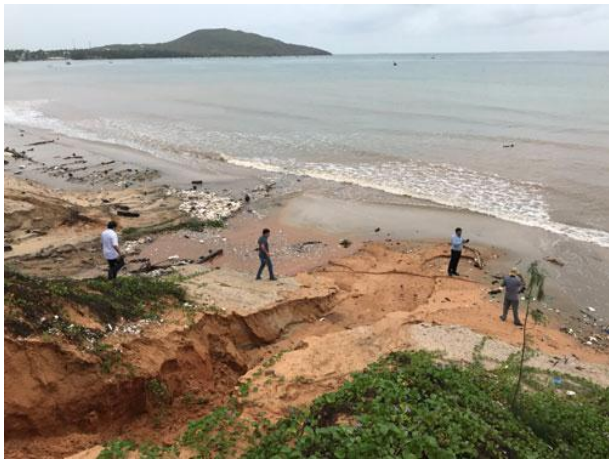
Đoàn kiểm tra tại khu vực bị sạt lở
