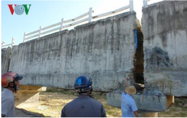
Nguyên nhân sự cố là do cả 2 khâu thiết kế và thi công
