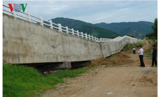
Cầu máng thủy lợi Sông Dinh 3 (Hàm Tân, Bình Thuận) bị gãy sập sau cơn mưa lớn ngày 13/6/2016
