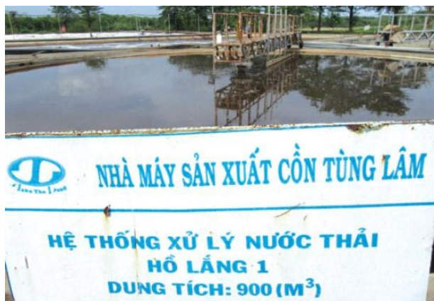
Hệ thống xử lý nước thải tại Nhà máy sản xuất cồn Tùng Lâm trên địa bàn tỉnh Đồng Nai. Ảnh: baobinhthuan.com.vn
