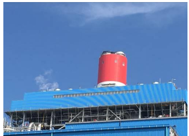
Tổ máy số 2 Dự án Nhà máy Nhiệt điện Vĩnh Tân 4 đã thực hiện đốt than lần đầu thành công
