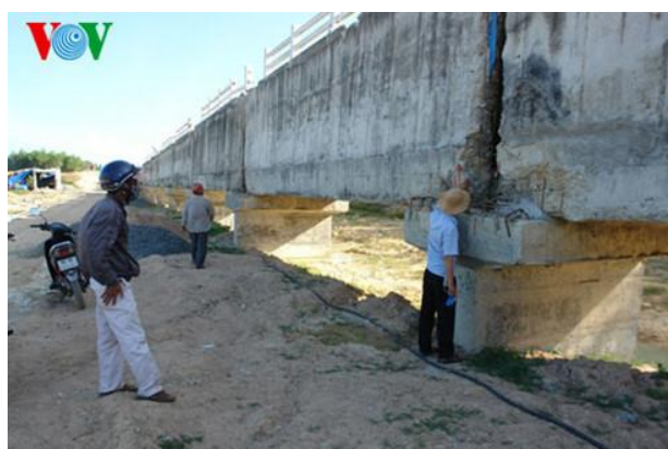
Cầu máng số 3 trên kênh chính Tây bị gãy sập đến nay vẫn chưa được khắc phục
