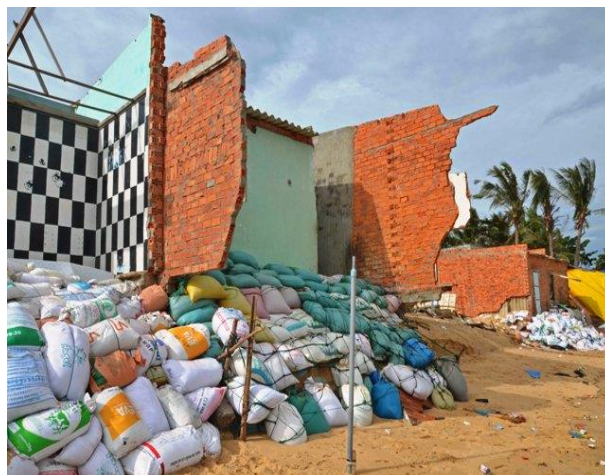
Một căn nhà bị sập hoàn toàn.
