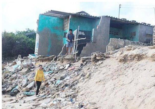
Nhiều căn nhà của ngư dân thôn Quý Thạnh, xã Ngũ Phụng, huyện đảo Phú Quý, tỉnh Bình Thuận bị sụp đổ vì biển xâm thực.
