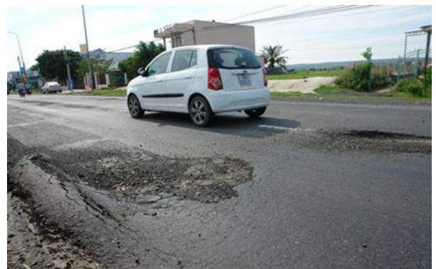
Vị trí sụt lún nặng ở Km1641 qua xã Hồng Thái, huyện Bắc Bình
