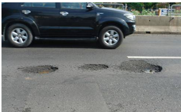
"Ổ gà" trên đường gây nguy hiểm cho các phương tiện tham gia giao thông
