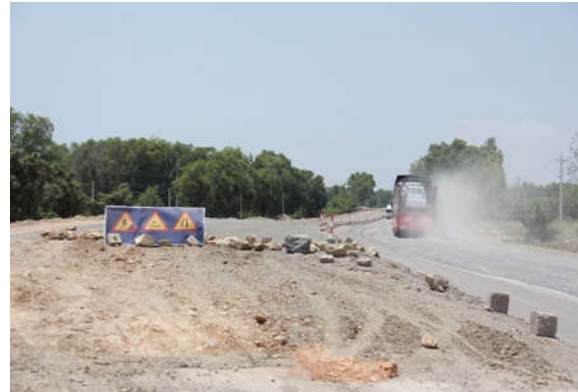
Một số đoạn trên tuyến thi công chưa đảm bảo ATGT và vệ sinh môi trường
