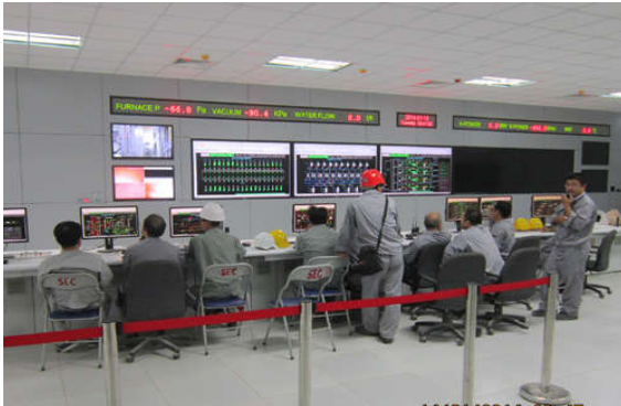
Tổ máy số 1 Nhà máy Nhiệt điện Vĩnh Tân 2 đã hòa lưới điện tháng 1-2014-Báo QĐND
